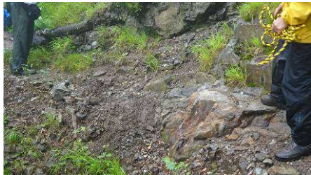
木橋傍の崩壊箇所
